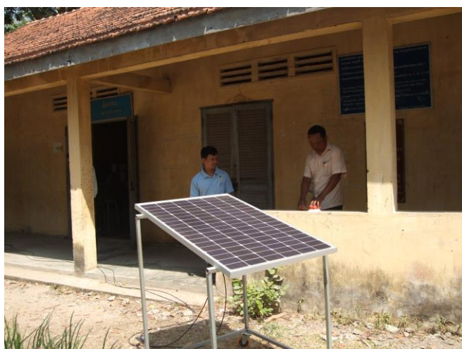
写真：プラティアート中学校庭に設置された太陽光発電パネル。
