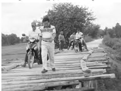
不安定な板の橋
